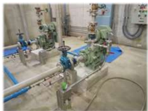
【新瀬田浄水場 下水道放流設備】
