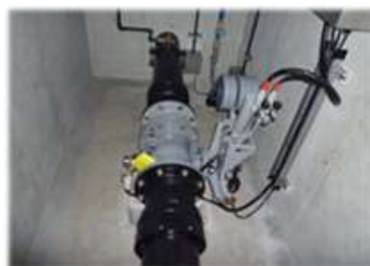
【緊急遮断弁（藤尾奥町配水池）】
