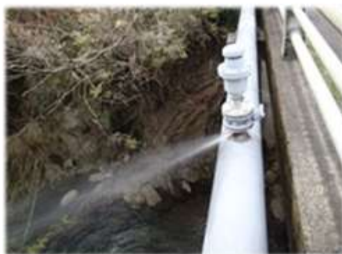
【水管橋の漏水状況】
