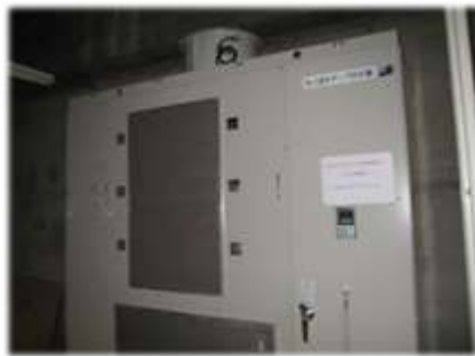
【インバーター※19 送水設備（真野浄水場）】
