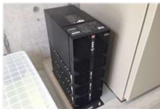
【無停電電源装置（UPS）】
